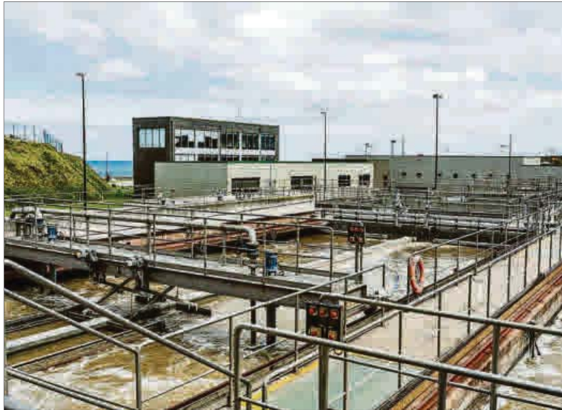
Instalaciones de la planta depuradora de aguas residuales de Bens. // La Opinión
