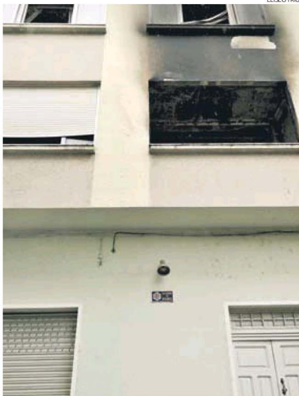
Fachada del edificio de Monforte afectado por el incendio.
