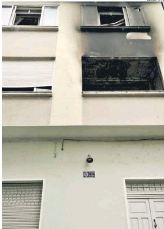
Fachada del edificio de Monforte afectado por el incendio.
